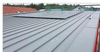
Nicht für jeden sofort ersichtlich, aber auf dem Dach des Erweiterungsbaus befindet sich eine 9,9 kWp große PV-Anlage.
